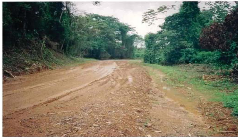
Daños sobre la superficie de rodamiento recientemente reparada en el sector del camino Estación 514+600.
