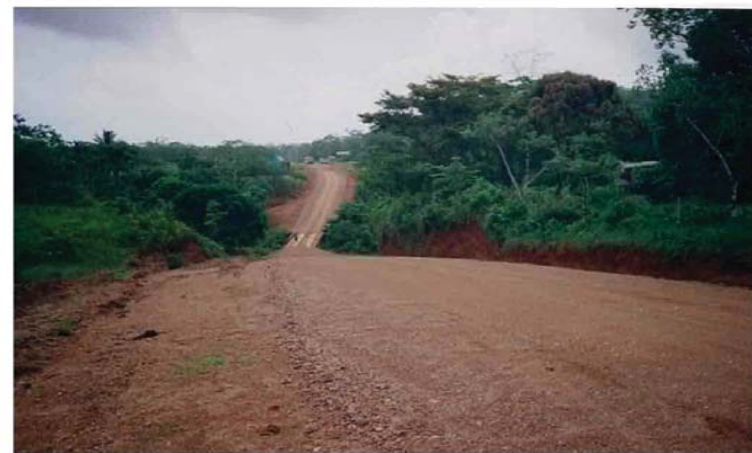
Reparaciones realizadas sobre la superficie dañada por las lluvias en la Cuesta de Truslaya, Estación 515+200.
