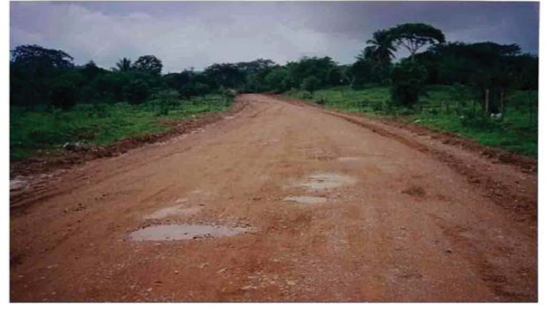
Daños leves producidos por las lluvias sobre el rodamiento en el sector del camino Estación 514+500
